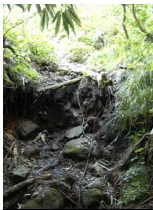
道路の下を通る大きな水路の手前に、右側に登る箇所あり。
